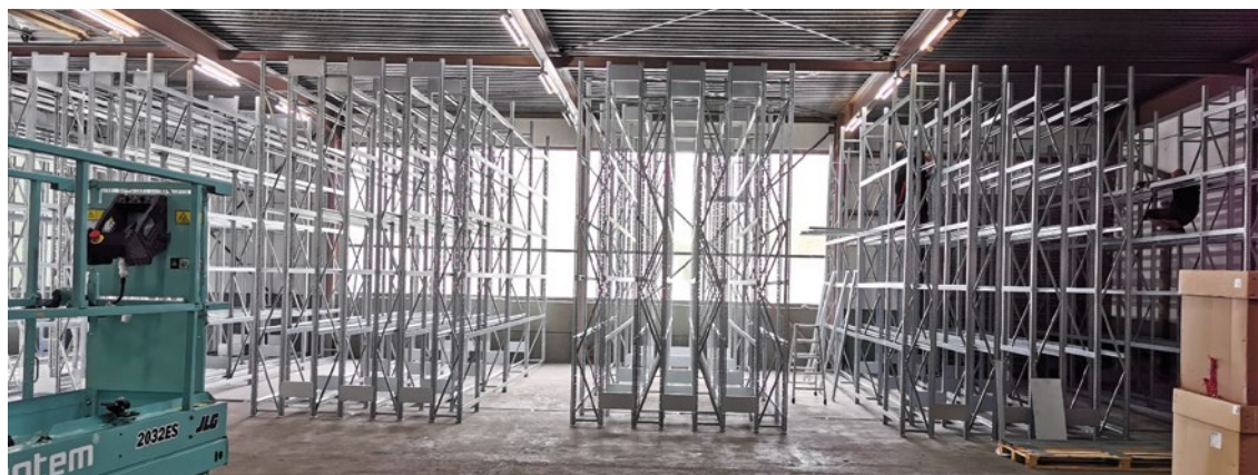
Die neue Reifen-Einlagerung
